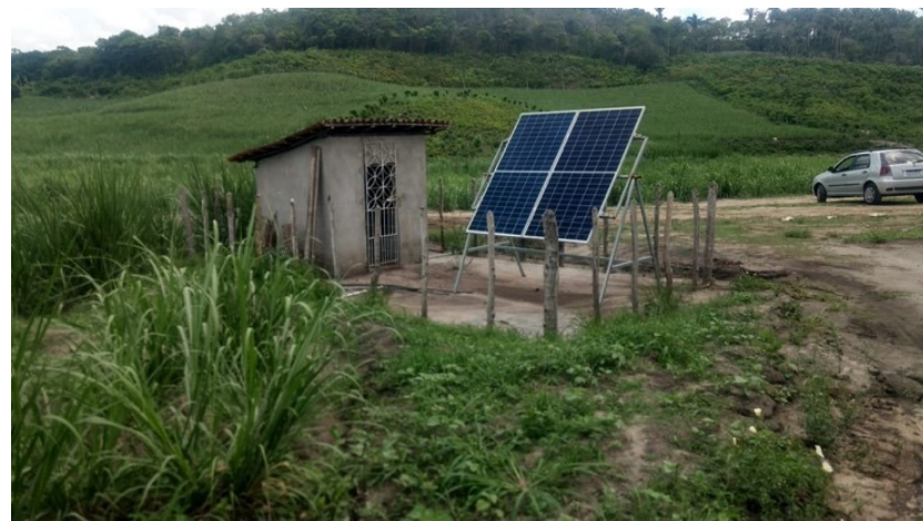
Solar Water Pump – Paraíba/Brazil (Source: SOL Luções Energia Solar)
